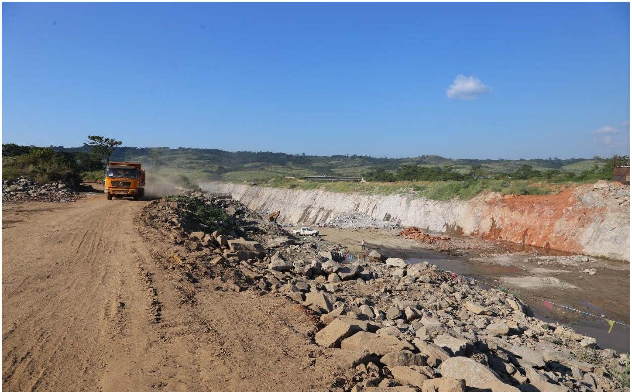
Construction de la deuxième prise d'eau à Inga, en vue du renforcement du débit dans le canal d'amenée d'eau vers les centrales Inga 1 et Inga 2
