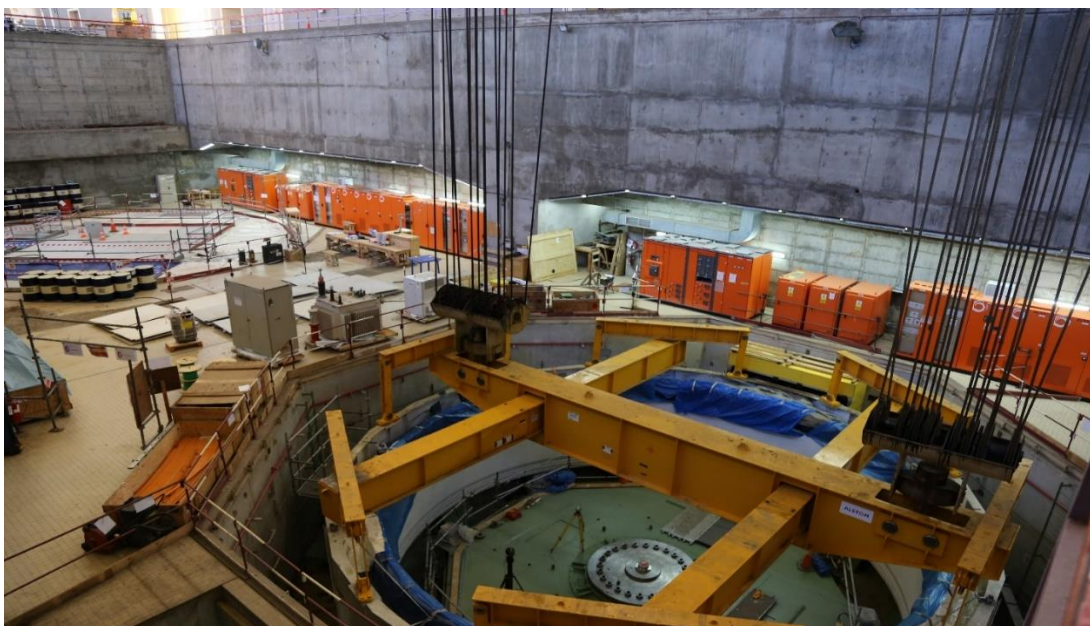
Travaux en cours de réhabilitation et modernisation du groupe 22 de la Centrale Inga 2, sur financement de la Banque Mondiale
